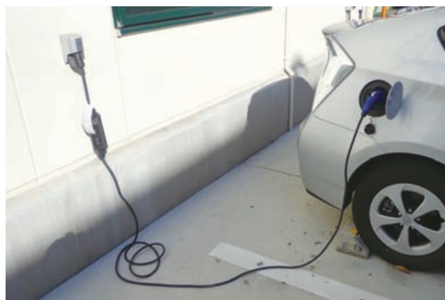
EV充電設備
