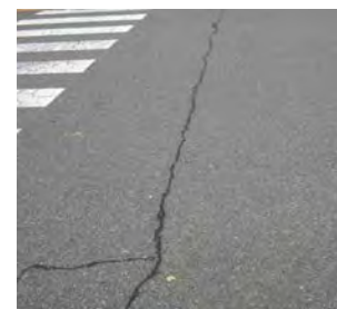
—クラック補修—
