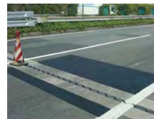
▲施工事例：ブラック ジョイント部やマンホール周りの段差修正
