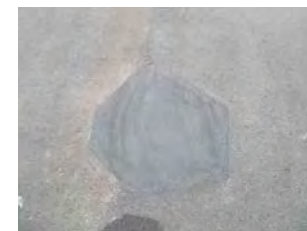
▲施工事例：ナチュラル（セメント色） 荒れた路面のリフレッシュ
