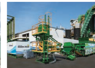
② 簡易設置型・強化路盤混合プラント
