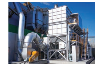
蓄熱式脱臭炉全景
