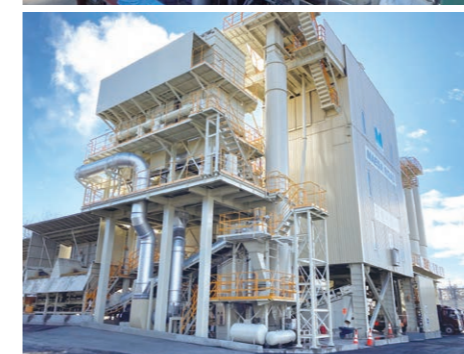
名古屋合材工場 蓄熱燃焼式脱臭炉 (愛知県)
