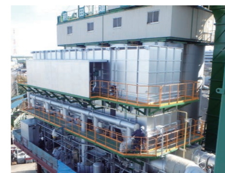
朝霞合材工場 蓄熱燃焼式脱臭炉 (埼玉県)
