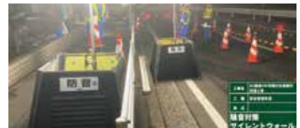
騒音対策のためのサイレントウォール
