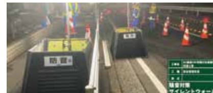
騒音対策のためのサイレントウォール
