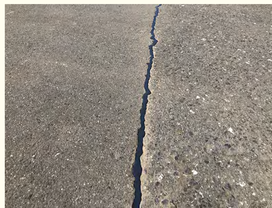
クラック補修
