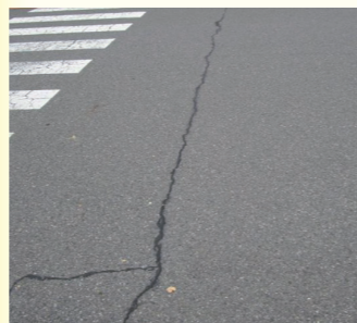
クラック補修
