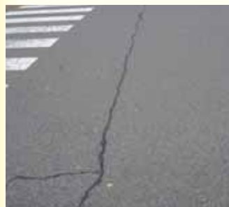
クラック補修
